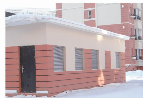
石河子天富玉城小区中水处理
