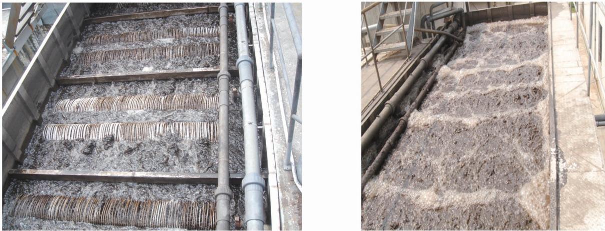
佛山冯了性药业有限公司制药废水处理工程
